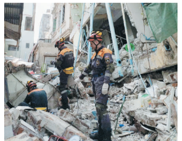
Специалисты МЧС принимают участие в ликвидации последствий жуткого землетрясения.
