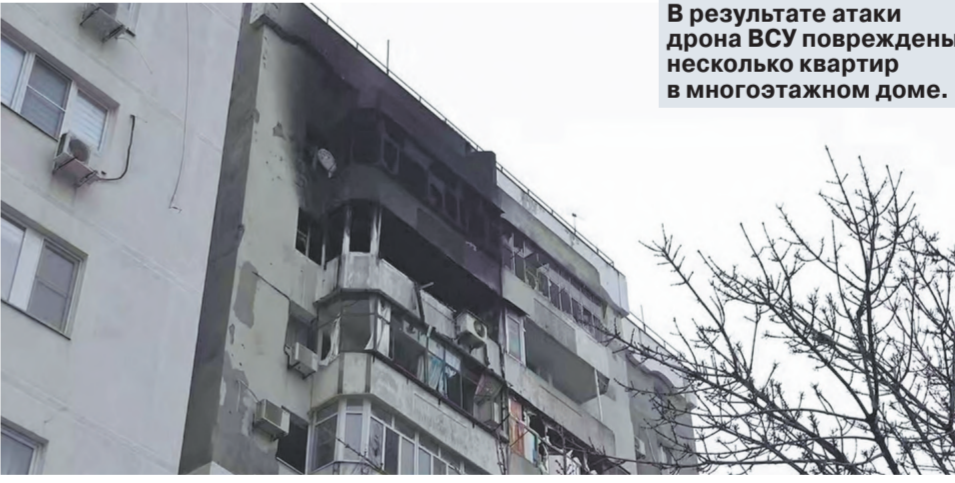
В результате атаки дрона ВСУ повреждены несколько квартир в многоквартирном доме.
